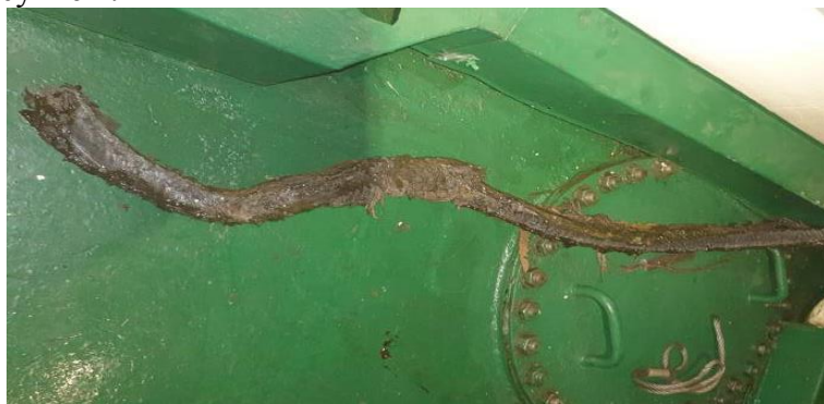
Рисунок 2 – Кольцо демонтированной сальниковой набивки
