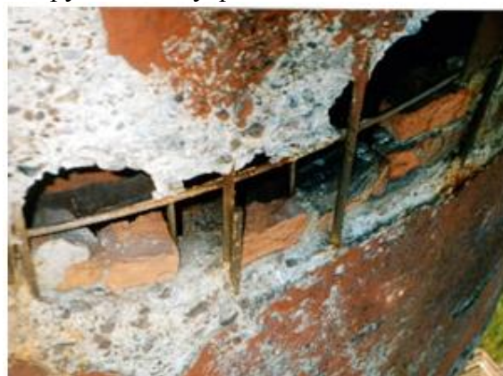
Сквозные отверстия в стене. Коррозия арматуры
