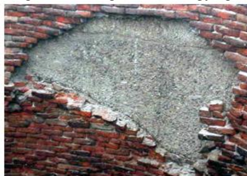
Разрушение внутреннего защитного слоя
