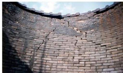
Трещины в верхней части футеровки
