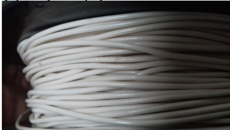
Рисунок 3 – Дефект изоляции по причине локального перегрева
